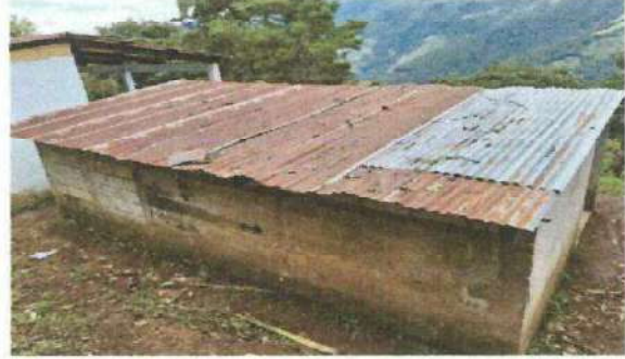
Foto 2: Vista exterior de la cubierta de lámina del módulo de la cocina con las láminas de zinc oxidadas y en mal estado.
