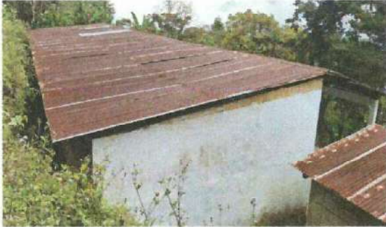
Foto 1: Estado actual de la cubierta de lámina del modulo de las aulas con las láminas de zinc oxidadas y deterioradas con agujeros.
