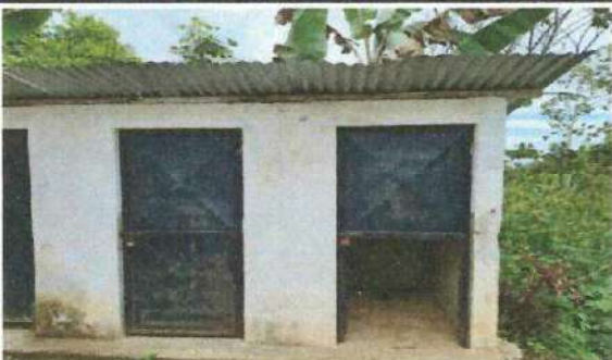
Foto 5: En el módulo de los servicios sanitarios amerita la sustitución de las puertas e inodoros por el deterioro que se encuentran actualmente.
