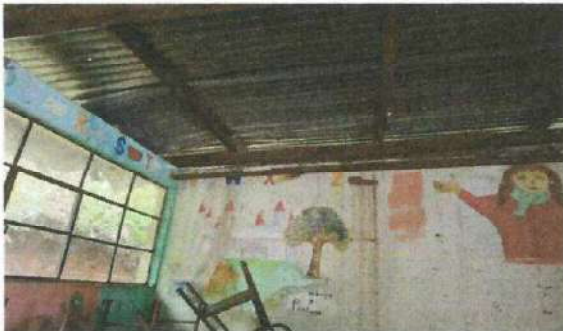
Foto 3: La estructura de techo del módulo de las aulas con soporte de madera deterioradas por el tiempo que amerita sustitución por metal.
