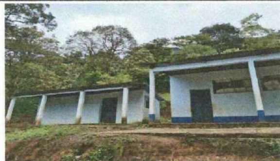
Foto 6: Las paredes requieren de mantenimiento con aplicación de pintura en muros exteriores e interiores.
